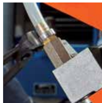
Ermetizzazione raccordo tubo sulla lubrificazione centralizzata
